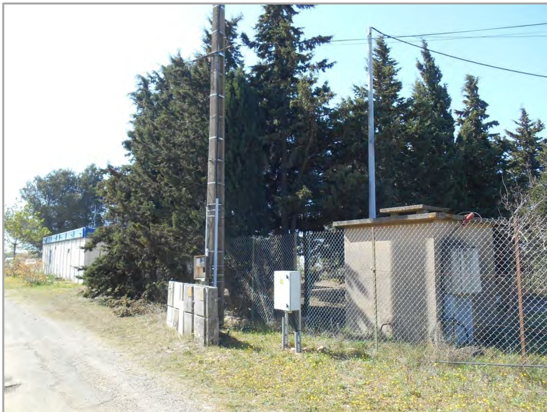
Photographie 37 : Ligne électrique basse tension et boîtes électriques à l'est de la zone d'étude- Avril 2021
